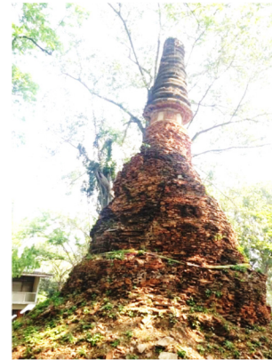
รูปที่ 1 ตัวอย่างความเสียหายที่เกิดขึ้นกับอิฐของโครงสร้างวัดกระเจี [4]
