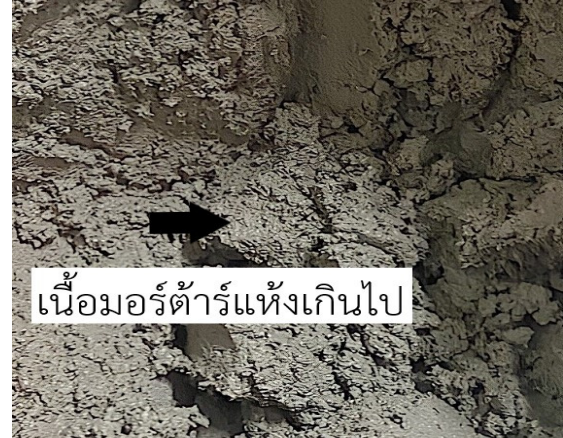
รูปที่ 3 เนื้อมอร์ตาร์แห้ง เนื่องจากใส่สารลดน้ำอย่างมากน้อยเกินไป
