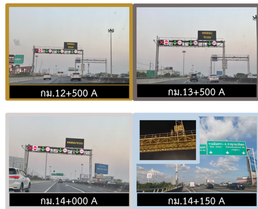
รูปที่ 4 การแสดงผลของระบบบริหารจัดการช่องจราจรบนทางพิเศษแบบอัตโนมัติ (Automatic Lane Control System)
