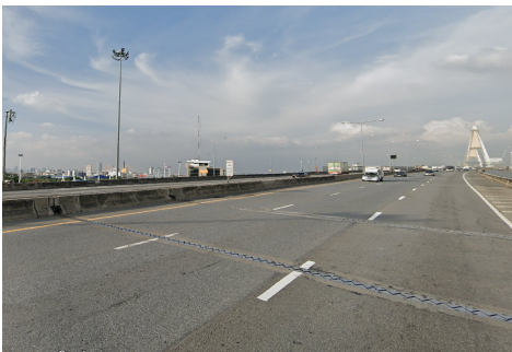
รูปที่ 2 รูปแบบของรอยต่อแบบแผ่นเหล็กฟันปลา (Steel Finger Joint) ที่ได้มีการติดตั้งใช้งาน
