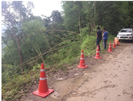
รูปที่ 1 ความเสียหายของลาดคั่นทางบริเวณพื้นที่โครงการ
