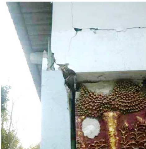
รูปที่ 1 ความเสียหายบริเวณจุดต่อคาน-เสาของอาคารเรียน โรงเรียนแม่ลาววิทยาคม จังหวัดเชียงราย
