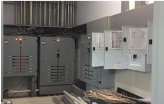
รูปที่ 4 ห้องจ่ายไฟ
