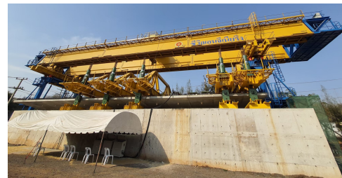
(b) ภาพการวาง loading frame และแม่แรงไฮดรอลิก รูปที่ 5 การทดสอบ Shear test ของโครงสร้าง Viaduct
