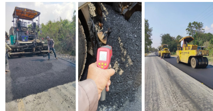
รูปที่ 16 ขั้นตอนการปูผิวทางด้วยวัสดุแอสฟัลต์คอนกรีตผสมขยะพลาสติกบนสายทาง
