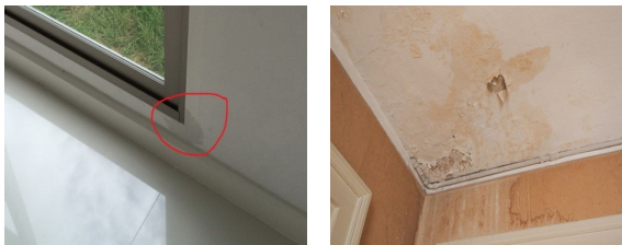
การรั่วซึมบริเวณวงกบ รอยด่างที่ฝ้าเพดานจากน้ำรั่วซึม
