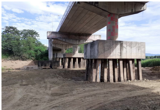
รูปที่ 3 ภาพการถูกกัดเซาะของฐานรากเสาเข็มกลุ่ม
