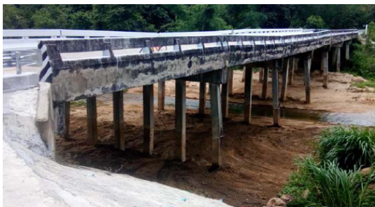
รูปที่ 2 ภาพด้านข้างสะพานที่ทรุดตัว
