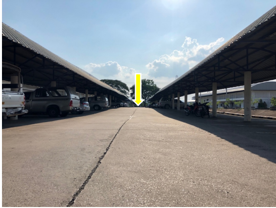
รูปที่ 17 ลักษณะผิวถนนคอนกรีตที่มีการบวมขึ้นมา
