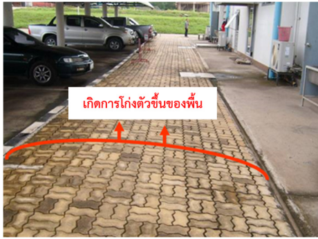
รูปที่ 6 การยกตัวของอิฐปูทางเท้ารอบอาคารโรงงาน
