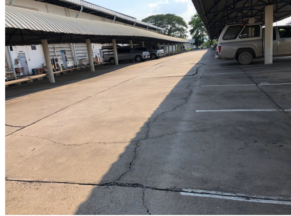
รูปที่ 18 รอยแตกบนถนนระหว่างคูน้ำกับอาคารที่เสียหาย
