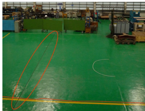
รูปที่ 5 รอยแยกของแผ่นพื้นคอนกรีตภายในอาคารโรงงาน
