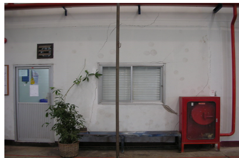
รูปที่ 4 รอยร้าวของผนังภายในอาคารโรงงาน
