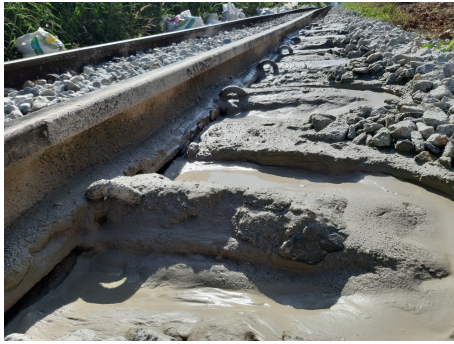
รูปที่ 2 ตัวอย่างลักษณะโคลนทะเล็ก (กม.748/6-12 สายใต้)
