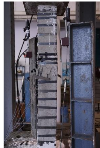
รูปที่ 8 ลักษณะการวิบัติของเสาคอนกรีตเสริมเหล็กที่เสริมกำลังด้วยสายรัดเหล็ก (ระยะห่างเท่ากับ 75 มิลลิเมตร)
