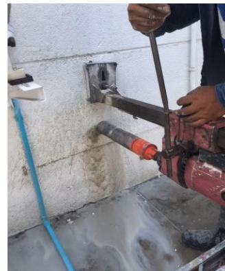
รูปที่ 3 การเจาะตัวอย่างคอนกรีตเพื่อทดสอบความลึกคาร์บอนเนชัน
