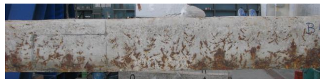
รูปที่ 12 การเกิดสนิมของเส้นใยเหล็กและเหล็กเสริมในคานคอนกรีตภายหลังจากเผชิญสิ่งแวดล้อมคลอไรด์แบบวัฏจักรเปียกสลับแห้ง 2 ปี
