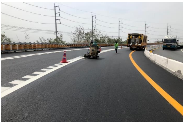
รูปที่ 3 การตีเส้นจราจรใหม่โดยเพิ่มความกว้างของไหล่ทางด้านขวา (โค้งใน) เพื่อแก้ปัญหาทรุดหนักกำแพงคอนกรีต
