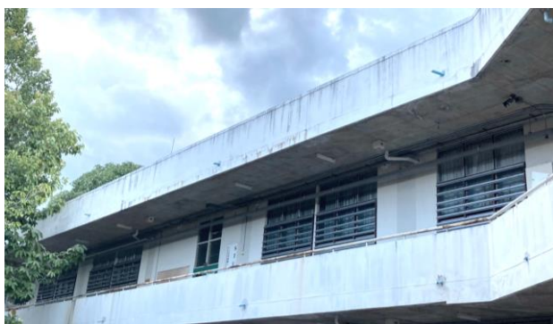
รูปที่ 6 ปัญหาสีภายนอกอาคาร
