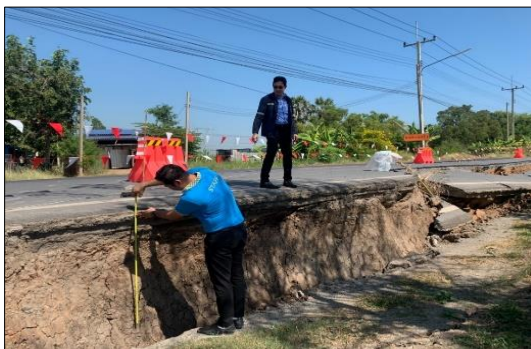
รูปที่ 1 ปัญหาดินถนนเลียบคันคลองทรุดตัวเนื่องจากระดับน้ำในคลองลดระดับลงถนนสาย อย.1043 จังหวัดพระนครศรีอยุธยา กรมทางหลวงชนบท (มกราคม 2563)
