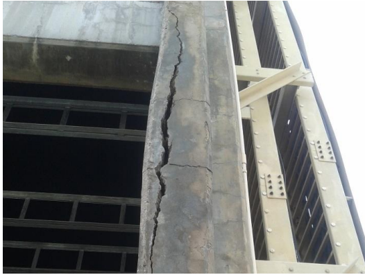
รูปที่ 13 รอยร้าวบริเวณเสาของอาคารหอหล่อเย็น
