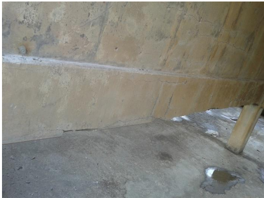
รูปที่ 14 รอยร้าวบริเวณคานของอาคารหอหล่อเย็น
