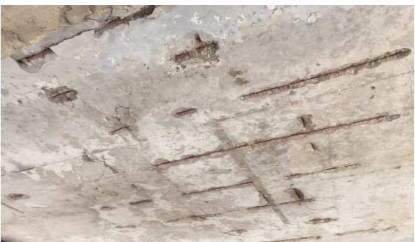
รูปที่ 11 การหลุดร่อนของผิวคอนกรีตบริเวณพื้น
