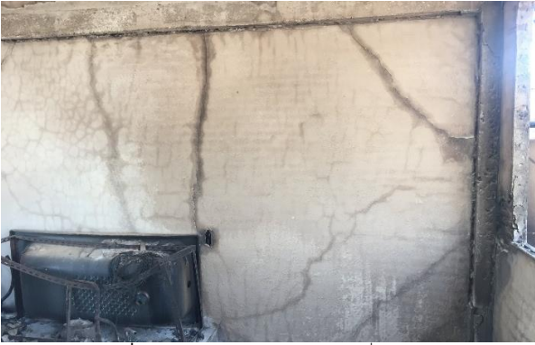
รูปที่ 9 รอยร้าวบริเวณผนังของอาคารที่ถูกเพลิงไหม้
