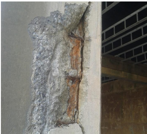
รูปที่ 16 การหลุดร่อนของผิวคอนกรีตบริเวณเสา
