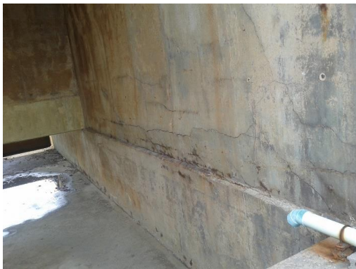
รูปที่ 15 รอยร้าวบริเวณผนังของอาคารหอหล่อเย็น
