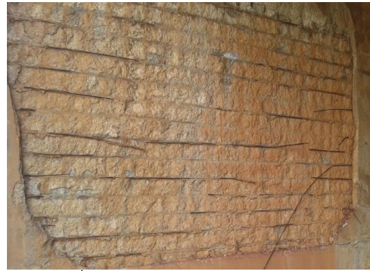
รูปที่ 18 การหลุดร่อนของผิวคอนกรีตบริเวณผนัง
