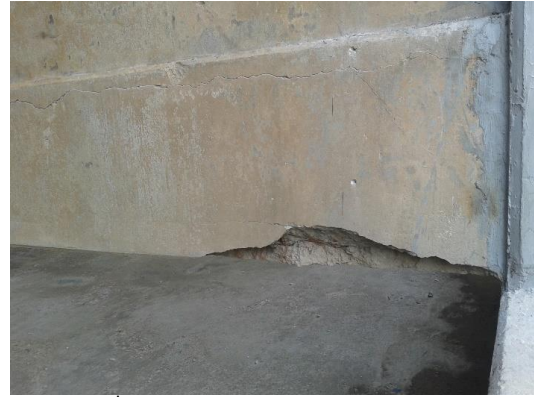
รูปที่ 17 การหลุดร่อนของผิวคอนกรีตบริเวณคาน
