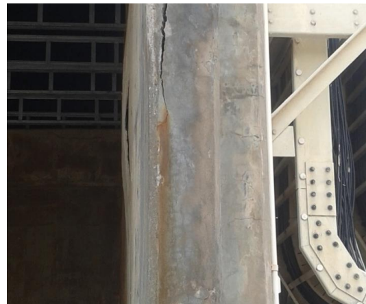
รูปที่ 19 การรื้อซึมของคราบสนิมจากรอยร้าวบริเวณเสา
