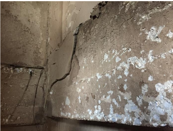
รูปที่ 10 รอยร้าวบริเวณคานของอาคารที่ถูกเพลิงไหม้
